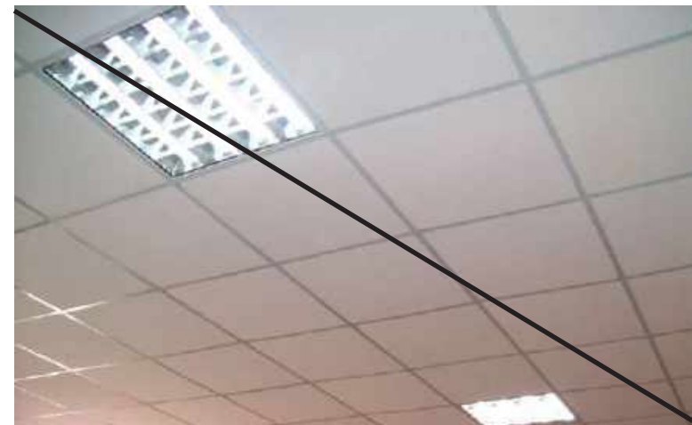
Плохо Открытые направляющие
