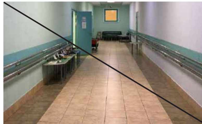
Плохо Керамогранитная плитка с крупными швами
