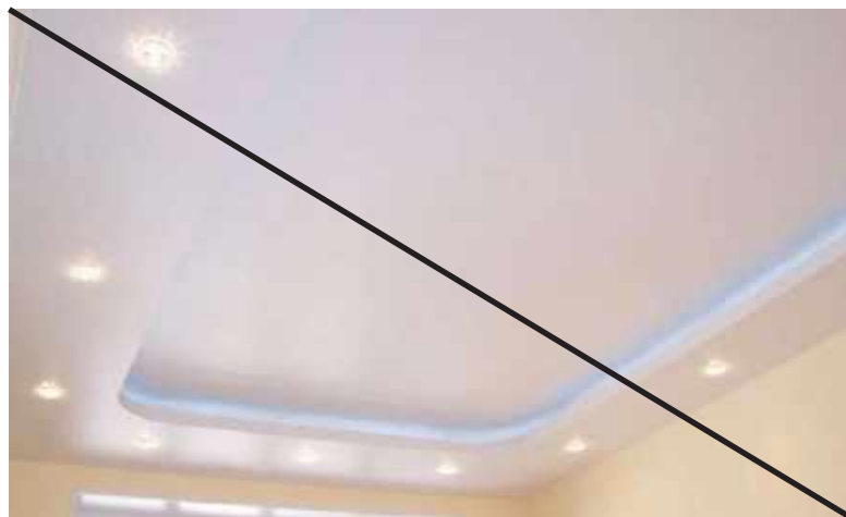
Плохо Многоуровневые гипсокартонные конструкции
