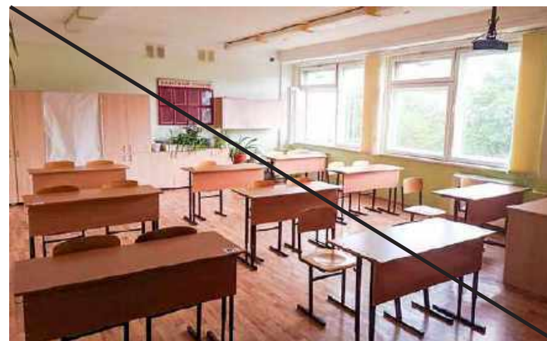
Плохо Линолеум под дерево
